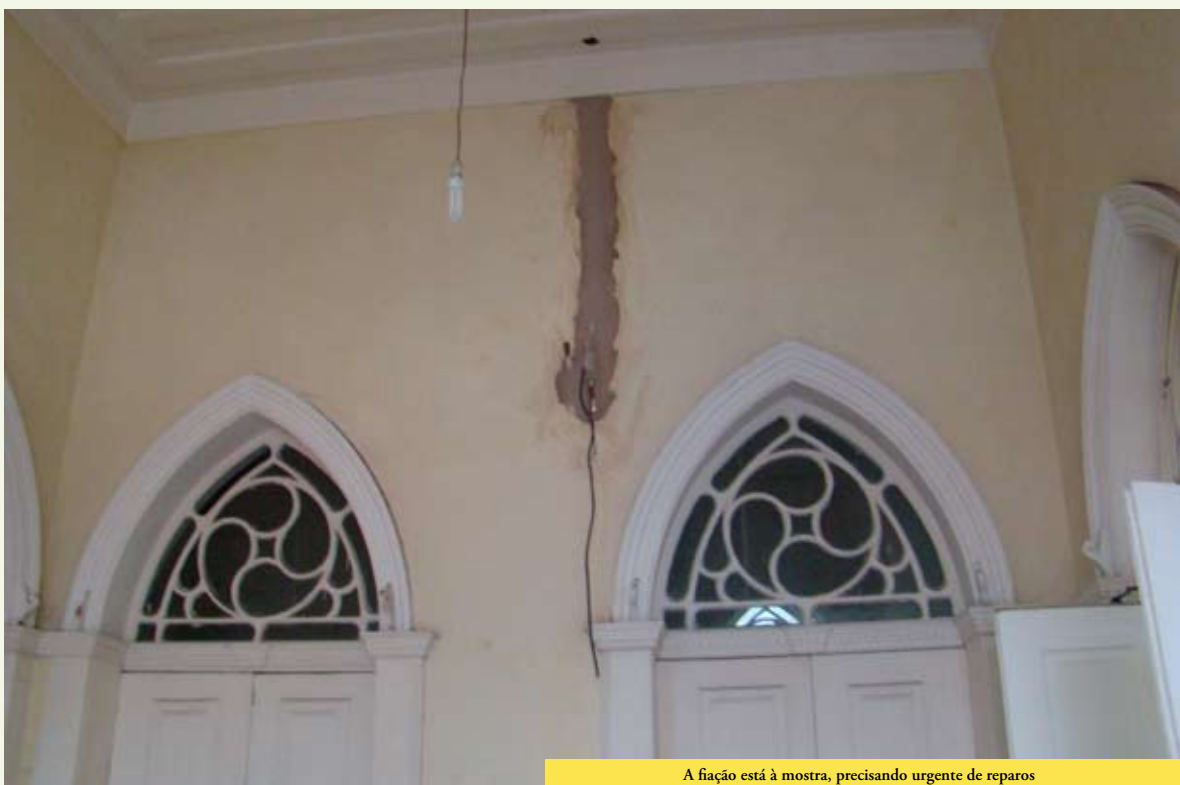
A fiação está à mostra, precisando urgente de reparos
