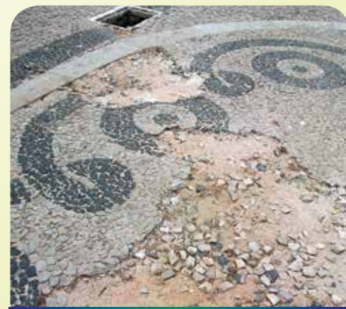
Nem mesmo simples reformas são feitas no local
